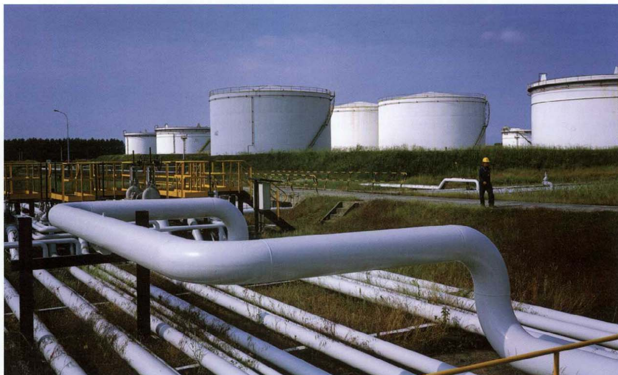
Italia (Volpiano) - Deposito carburanti.
