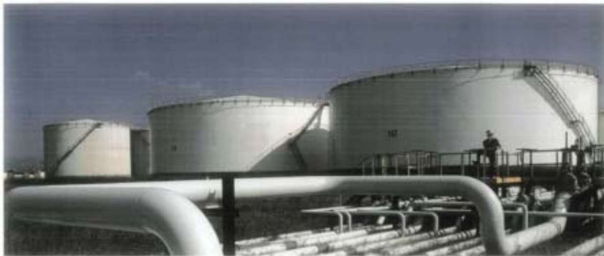
Italia: Impianto di stoccaggio.
