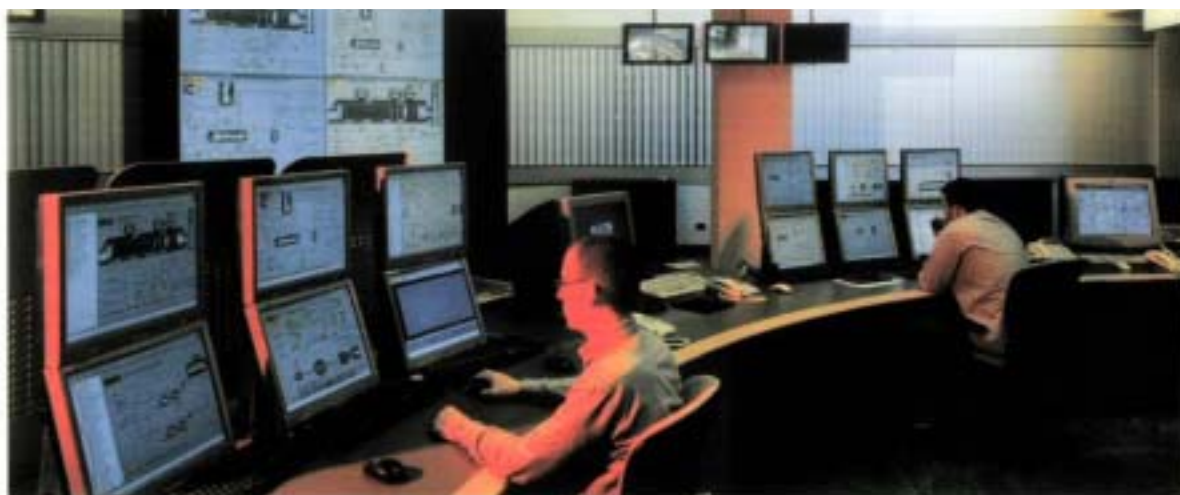
Italia: Sala di controllo della centrale EniPower di Ferrera-Erbognone.
