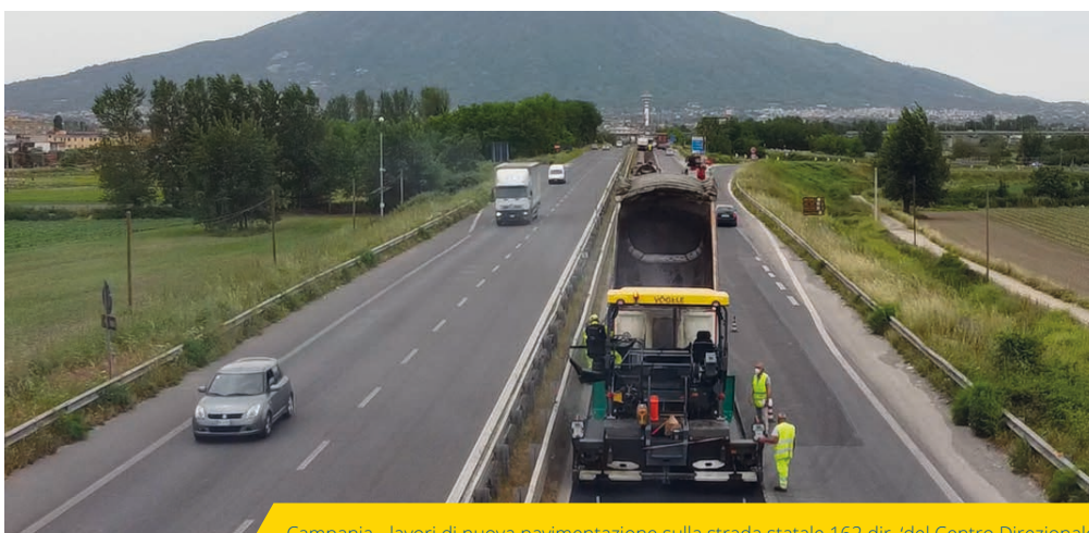
Campania - lavori di nuova pavimentazione sulla strada statale 162 dir. 'del Centro Direzionale'
