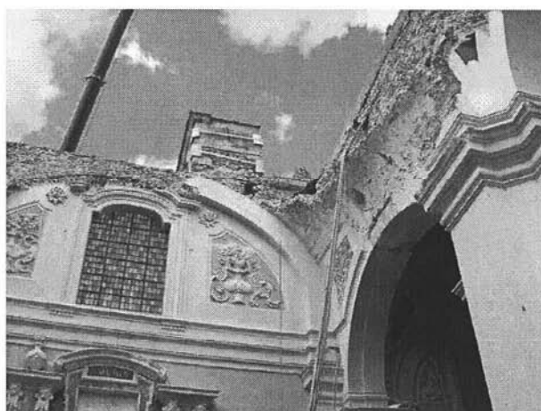
Basilica di Collemaggio - Veduta crolli con affreschi
